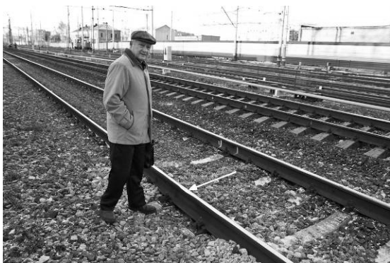
Рис. 11. Рельс в месте дефекта (указан стрелкой)
