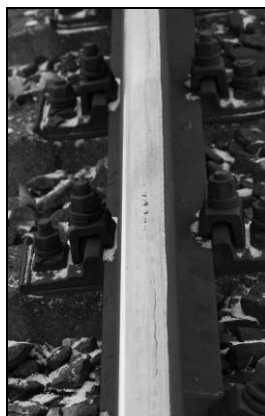
Рис. 17. Рельс с поверхностными дефектами
